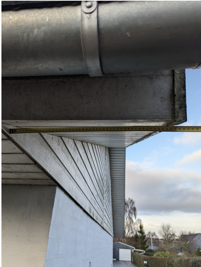
Figure 13: Taget i gavl stikker ca. 50cm ud fra muren.
