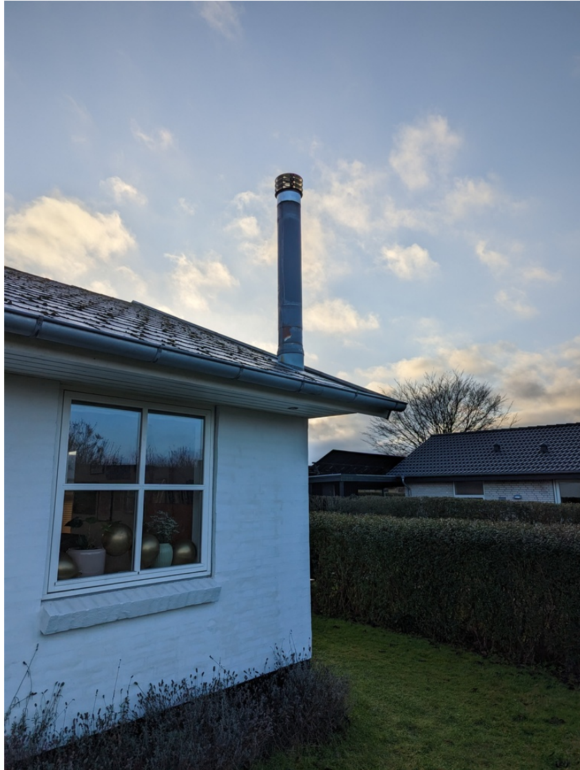
Figure 6: Skorsten ønskes fjernet.
