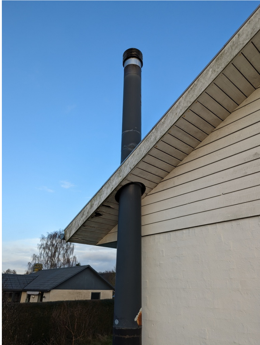
Figure 8: Bemærk råd i træ under skorsten
