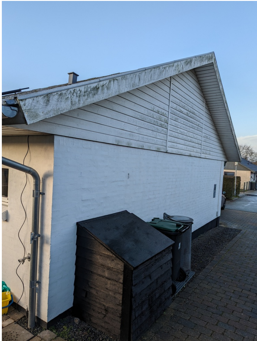
Figure 3: Østlige facade. Bemærk sort pumpehus og manglende ventilation
